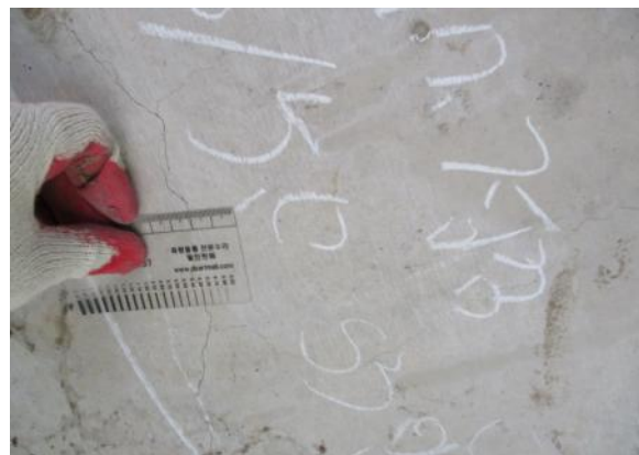
균열폭 측정 조사
